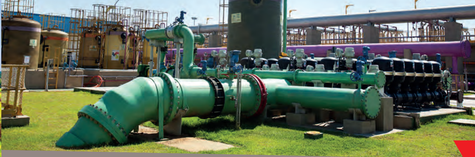
Estação de Tratamento de Água da Aquapolo Ambiental, em Santo André (SP)
